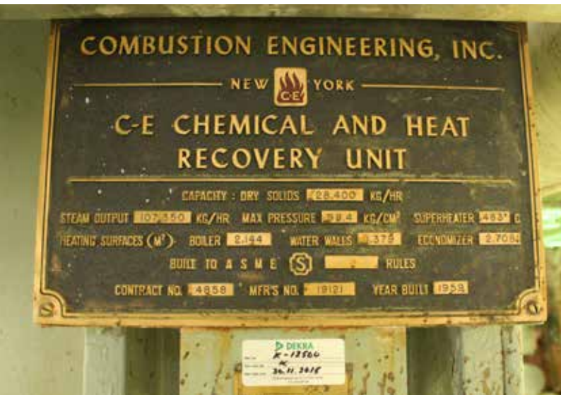
CE:n kilpi Suomen vanhimmassa toimivassa soodakattilassa Kotkassa
